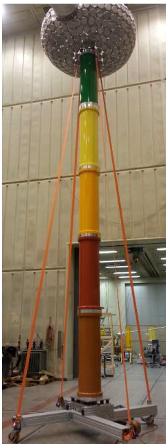
RISE 1000 kV divider
