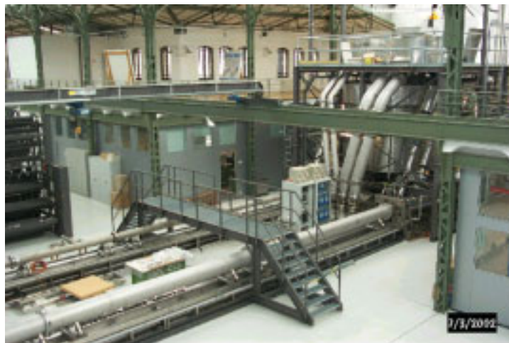
Volumenstrom-Messanlage im historischen Hermann-von-Helmholtz-Bau in Berlin mit 25 m langen Messstrecken (Nenndurchmesser 80 mm und 400 mm) und Wägebekälter (Volumen 20 m 3 )
