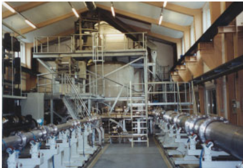
Messstrecken des Prüffeldes mit dem Wägesystem (im Hintergrund 30-t-Waage)
