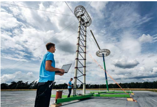
Die Hochspannungsmessanlage der PTB
