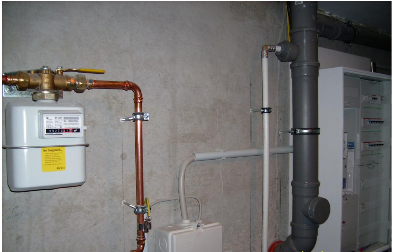
Photographie eines Balgengaszählers in einer Hausinstallation
