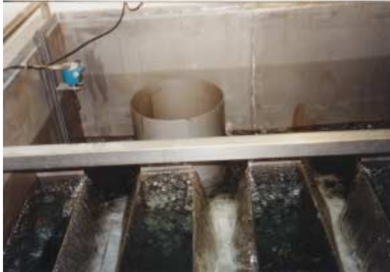
Bild 5 Hochbehälter mit Überlaufrinnen und Füllstandssensoren
