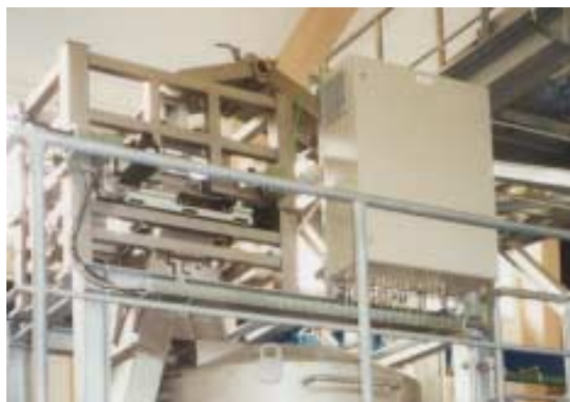
Bild 12 Mittlere Umschaltklappe über der 3-t-Waage
