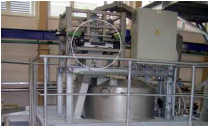
Abb. 5: 3-t-Waage mit Durchflussumschalteinrichtung (hervorgehoben durch kreisförmigen Marker)
